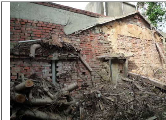
照片1-3 鄰房牆體產生結構性裂縫
