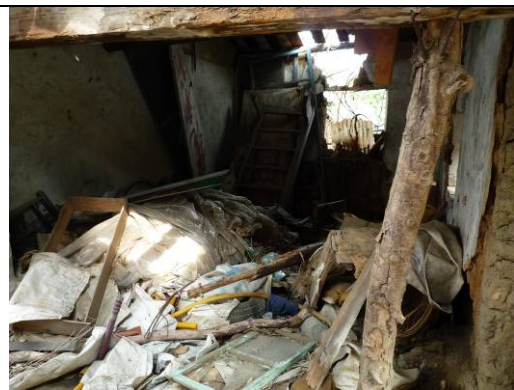
照片1-4 鄰房堆積諸多雜物
