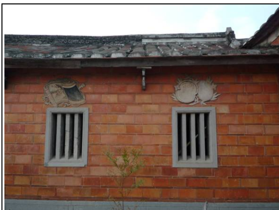
照片2-7 磚石構造的劣化檢測
